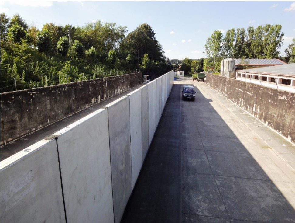
Bild 2: Repariertes Fahrsilo in Thüringen / Download-Link
